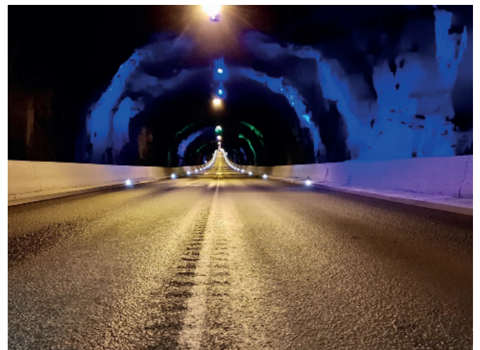
Tunnel lighting Nordoyatunnel Färöer
